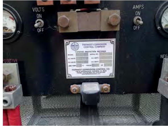
Rectifier Name Plate
